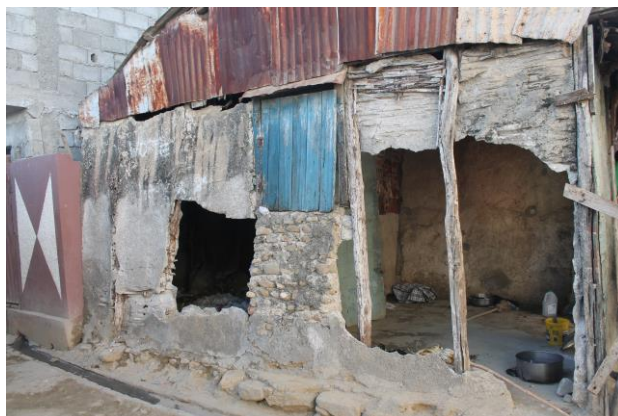
Une maison totalement endommagée par les inondations survenues dans la ville de Port-de-Paix dans la nuit du 21 au 22 décembre 2015. Crédit photo : OCHA Haïti
