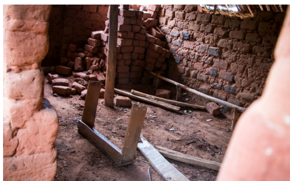
Etat d'une salle de classe de l'Institut Kamuandu, dans le territoire de Dibaya au Kasai Central. Les murs de cette école ont été détruits, des bancs cassés, des fournitures et dossiers brûlés. ©OCHA/I. Brandau
