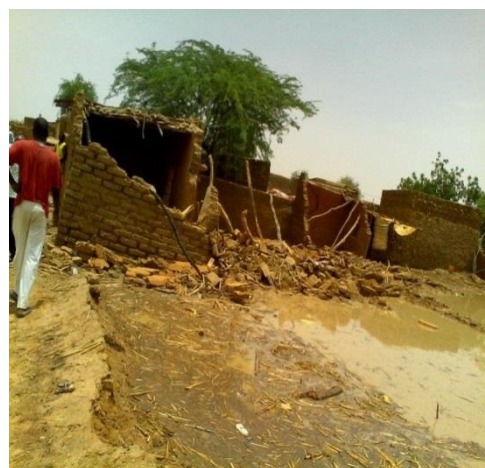
Maisons détruites par les pluies et les inondations à Zinder, Niger. Source: World Vision
