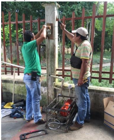
Crédito: Ingrid Camelo NRC Instalación de la electrobomba donada por NRC que permite a la comunidad tener agua potable después de 16 días.
